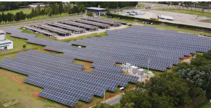
Usina solar na fábrica da Niterra, antiga NGK, em Mogi das Cruzes, SP: 10% do consumo de energia.
